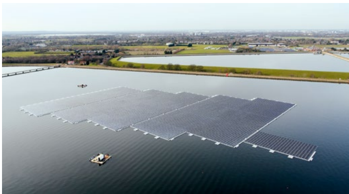
英国伦敦近郊的Lightsource BP的漂浮太阳能电站
